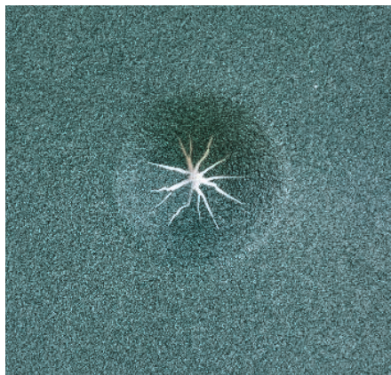
Odpryski na warstwie powłoki
