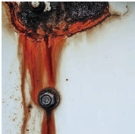
Korozja bimetaliczna / korozja galwaniczna
