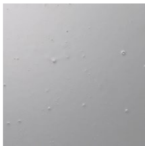
Défaut de surface dû au dégazage
