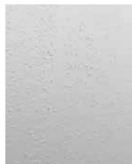
Défaut de surface dû au dégazage
